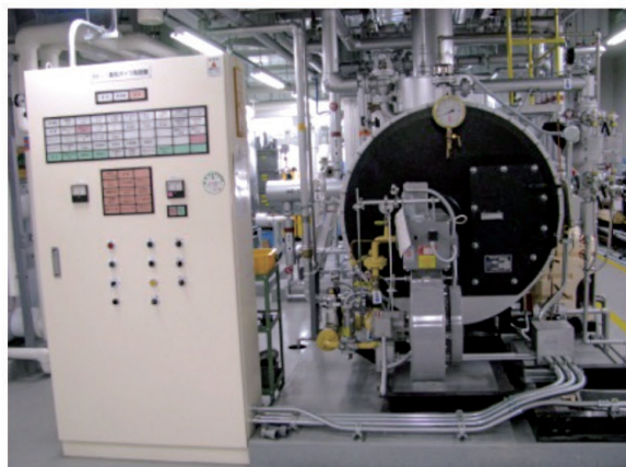
実習用蒸気ボイラー
